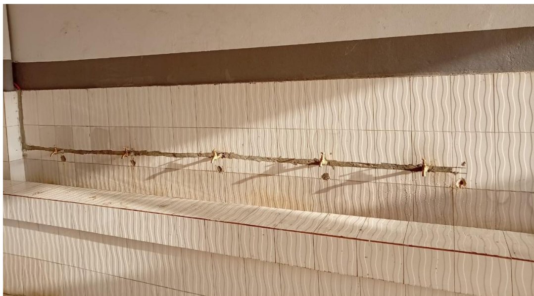
Fig.2 : État actuel d'un bloc sanitaire (robinetterie manuelle classique)
