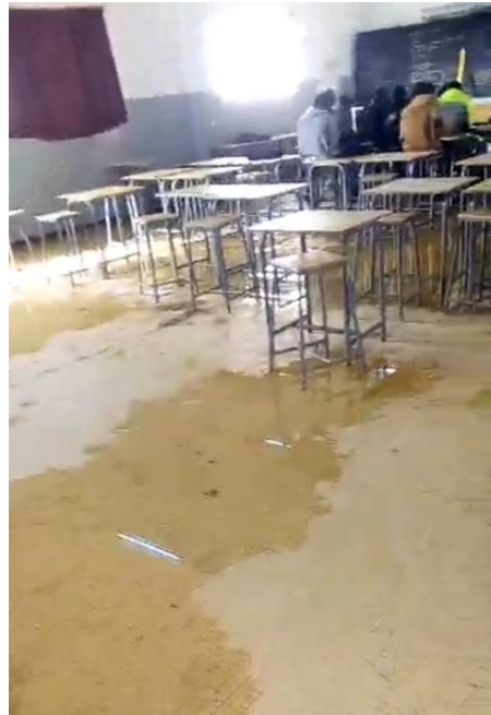
Fig.4 : Zone inondée – département Construction Mécanique (février 2026) | Lien vidéo : https://urli.info/1tvQ9
