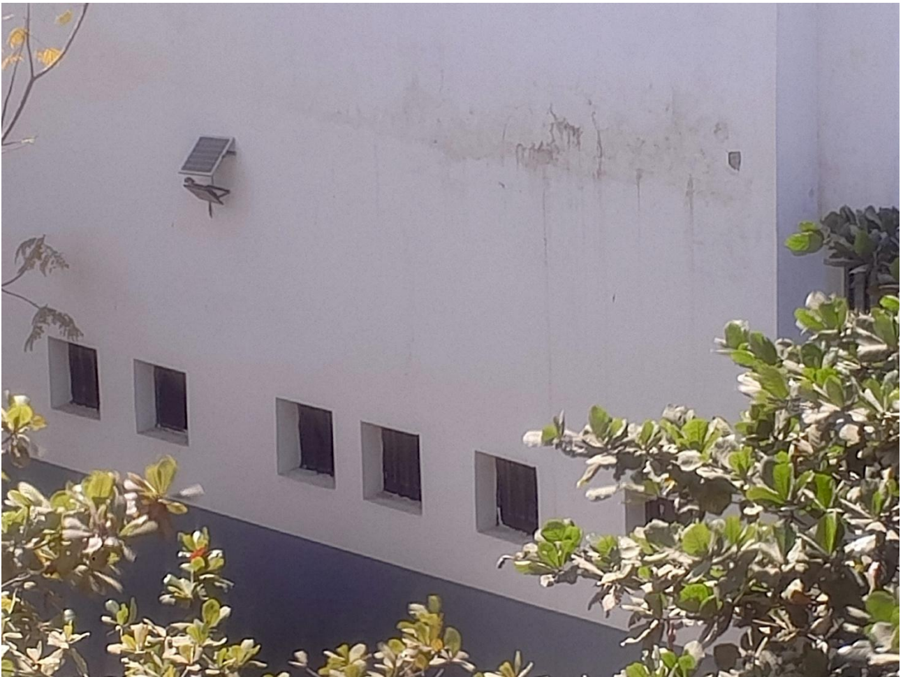
Fig.7 : Fuite réparée dans un conduit d'eau encastré au niveau du Bâtiment STIDD
