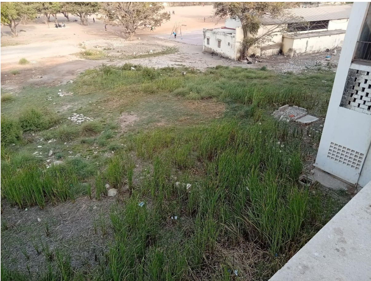
Fig.6 : Zones humides/boueuses derrière Bâtiment D (comparaison avant/après réparation)
